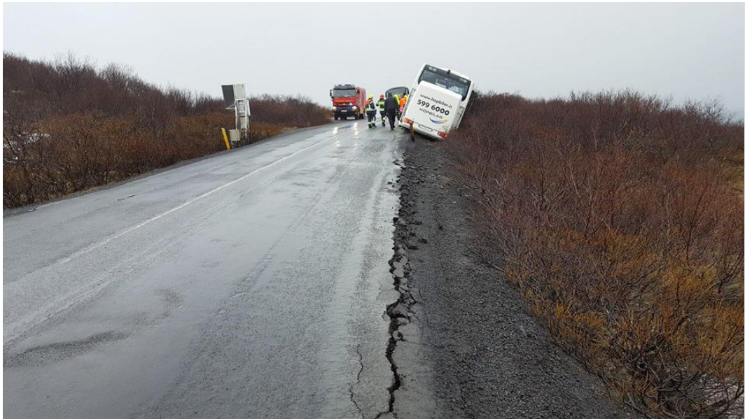
Mynd 2.1 Rúta sem fór að hluta til út af þegar vegkantur á Þingvallavegi gaf sig í apríl 2017. Ljósmynd: Lögreglan.
